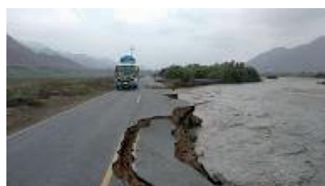
(a) Carretera afectada por inundaciones.
