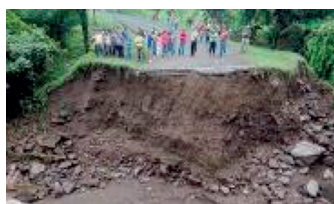
(b) Carretera afectada por deslave.
