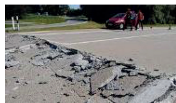
(c) Carretera afectada por calor extremo.
